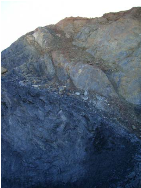
Imagen nº 42: Surgencia de agua en talud de desmonte
