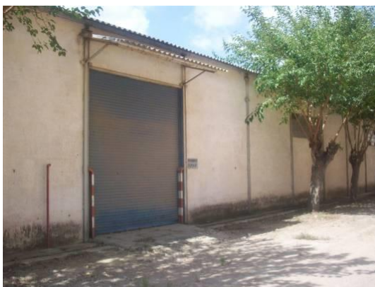
Fotog. 48. Barracones en buen estado de conservación.
