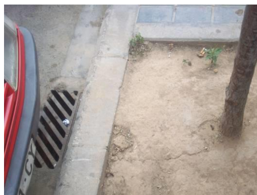
Fotog. 26. Alcorque y sumidero existentes.
