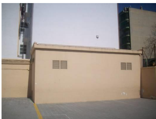
Fotog. 33. Centro de transformación situado junto a la entrada principal.
